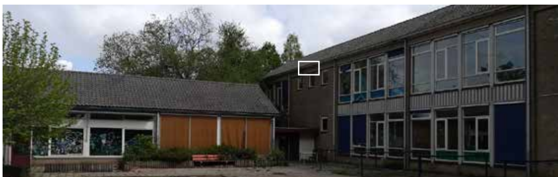
Figuur 4.1: Locatie kraamverblijfplaats, aanwezig in gescheurde gootbekisting, mestsporen zichtbaar.
