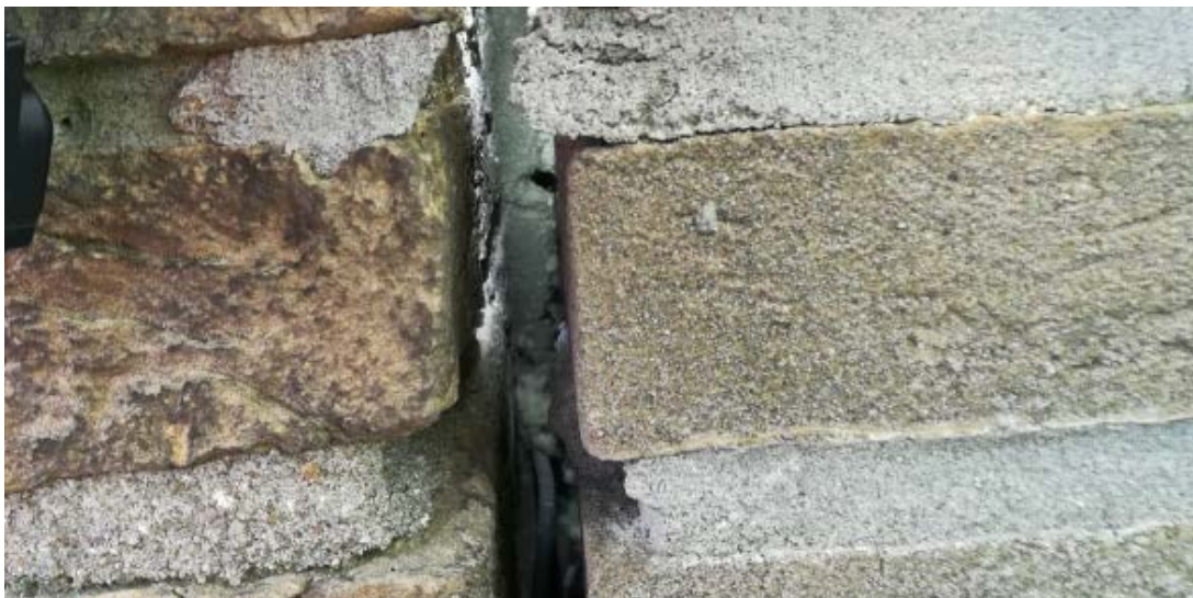
Enkele spleten en scheuren in de muren.
