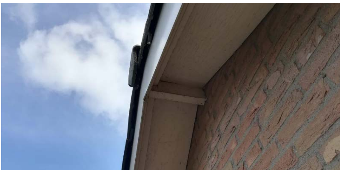
Er is een opening zichtbaar onder de nokpan.
